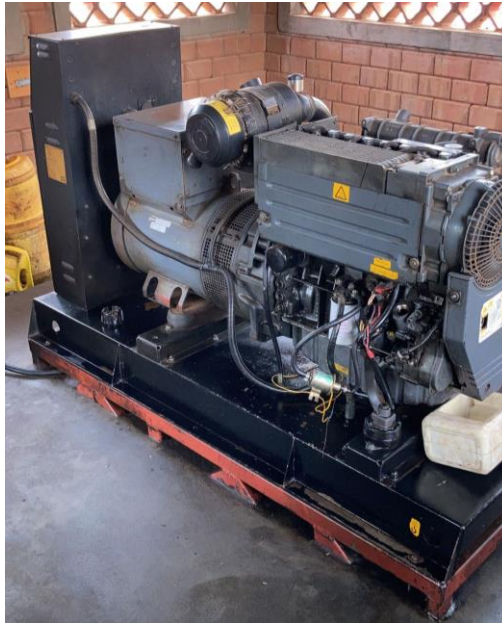
Figura 12. Grupo electrógeno. Generación térmica de la bomba
