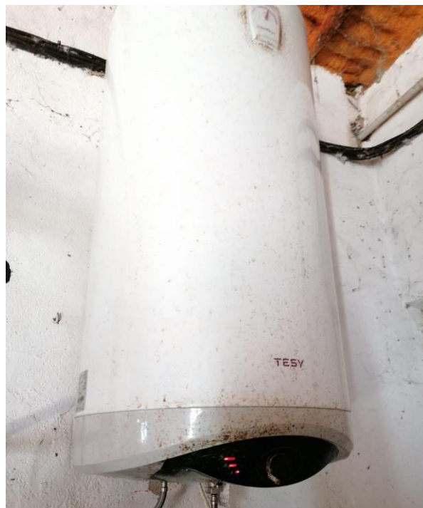
Figura 30. Termo agua caliente 100 L
