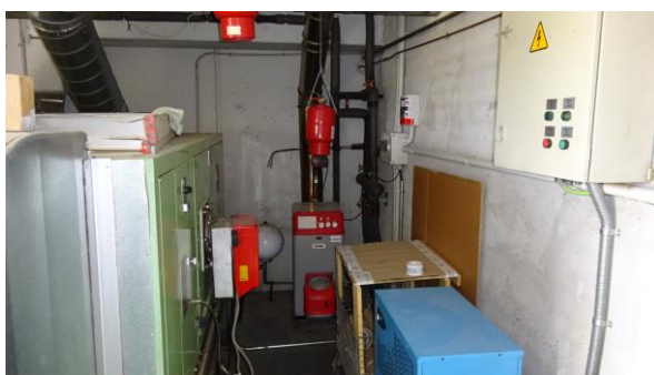
Figura 22. Sala de máquinas
