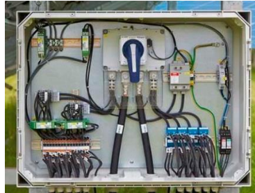
Figura 13. Protecciones y cableado para una instalación fotovoltaica. Fuente (Topsolar)
