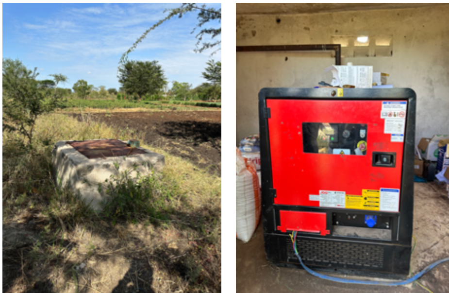
Ilustración 17 Pozo y su correspondiente generador en la Farm
