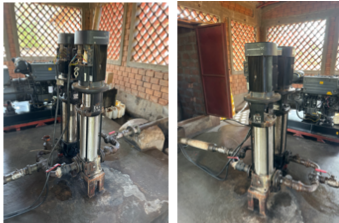
Ilustración 14 Bombas que componen el sistema de bombeo
