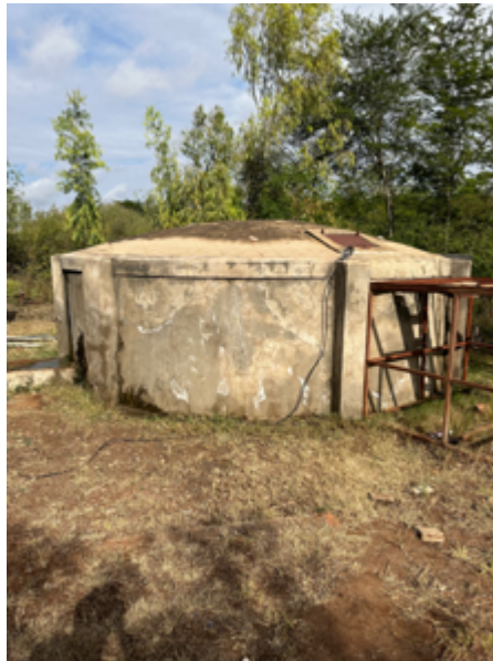
Ilustración 15 Depósito de la estación de bombeo
