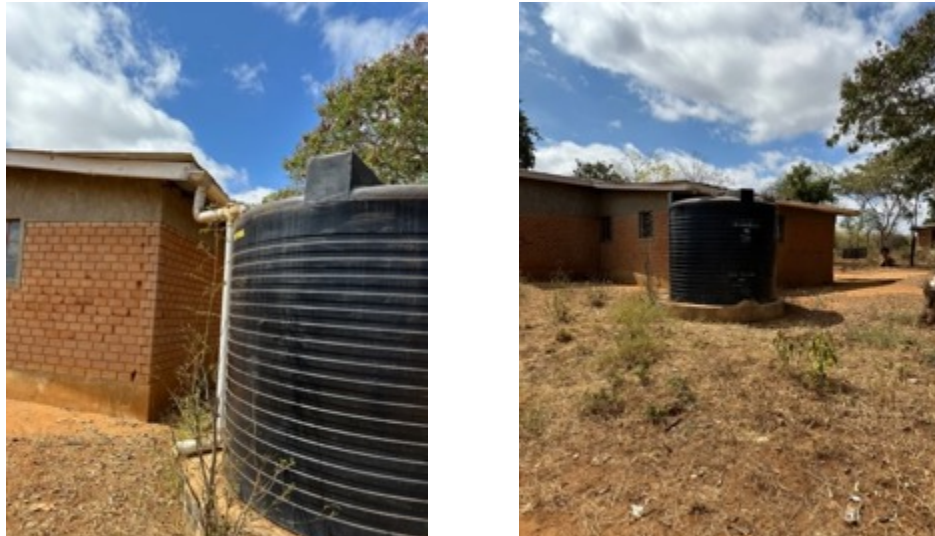
Ilustración 26 Tanque y Mecanismo de Captación de Aguas de Lluvia
