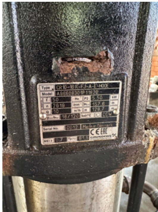
Ilustración 43 Placa Característica Bomba Estación de Bombeo
