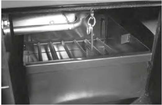
[Figura 5] Compactador de ceniza de las calderas de pelets KWB
