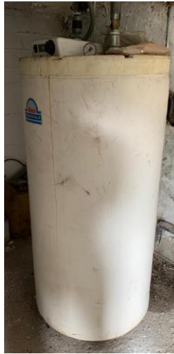
Ilustración 158. Interacumulador Roca Inoxidable 300 (Fuente: Elaboración Propia)
