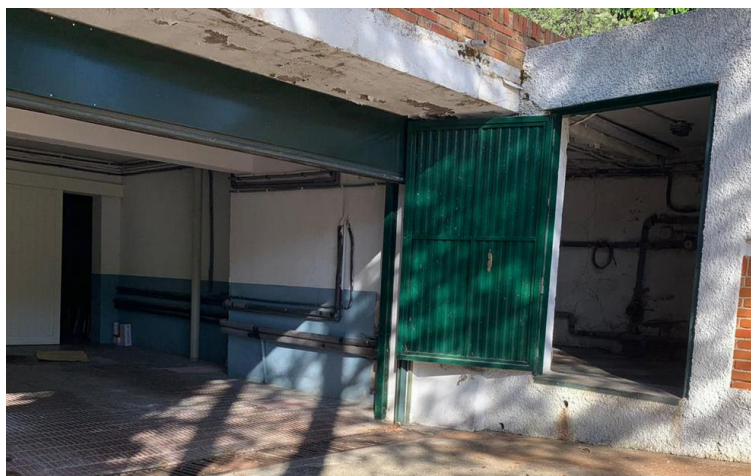
Ilustración 140. Entrada de la red de agua caliente en la vivienda desde el cuarto de calderas. (Fuente: Elaboración propia)
