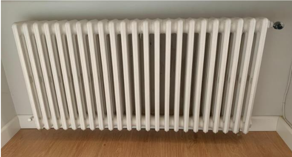
Ilustración 162. Radiadores Baxi Roca de hierro fundido. (Fuente: Elaboración Propia)
