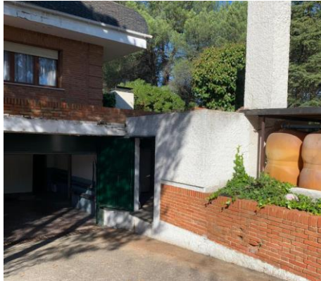
Ilustración 138. Imagen exterior del cuarto de calderas. En la parte derecha de la fotografía aparecen los antiguos depósitos de gasoil. (Fuente: Elaboración propia)
