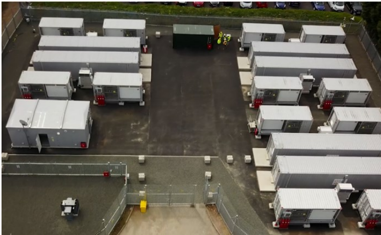
Fig. 3.16 Fotográfica del BESS de la tesis. (EASE, 2018)
