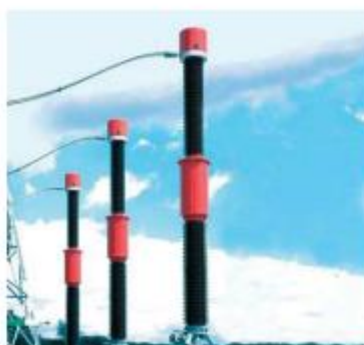
> Transformadores de tensión inductivos de 123 kV. Electronet Services (Nueva Zelanda).
