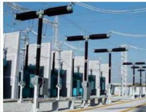
3AP2 FI 420 kV
