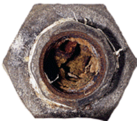
Figura 1-5. Bloqueo de una tubería por incrustaciones
