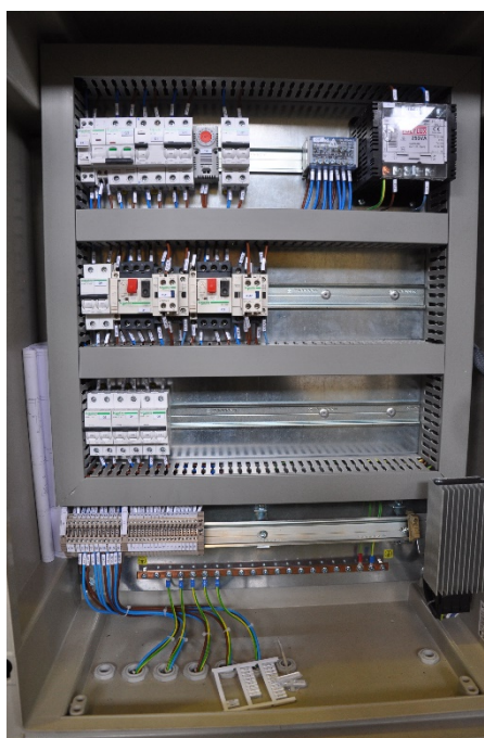
Figura 1-13. Interior del cuadro eléctrico.
