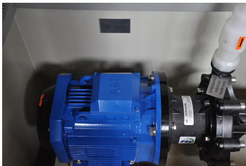
Figura 1-9. Conjunto motor - bomba de llenado
