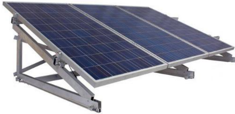
Figura 26: Paneles solares y soporte. Fuente: ECOSOLAR
