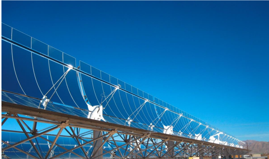
Imagen 3.5: Campo solar de cilindro parabólico
