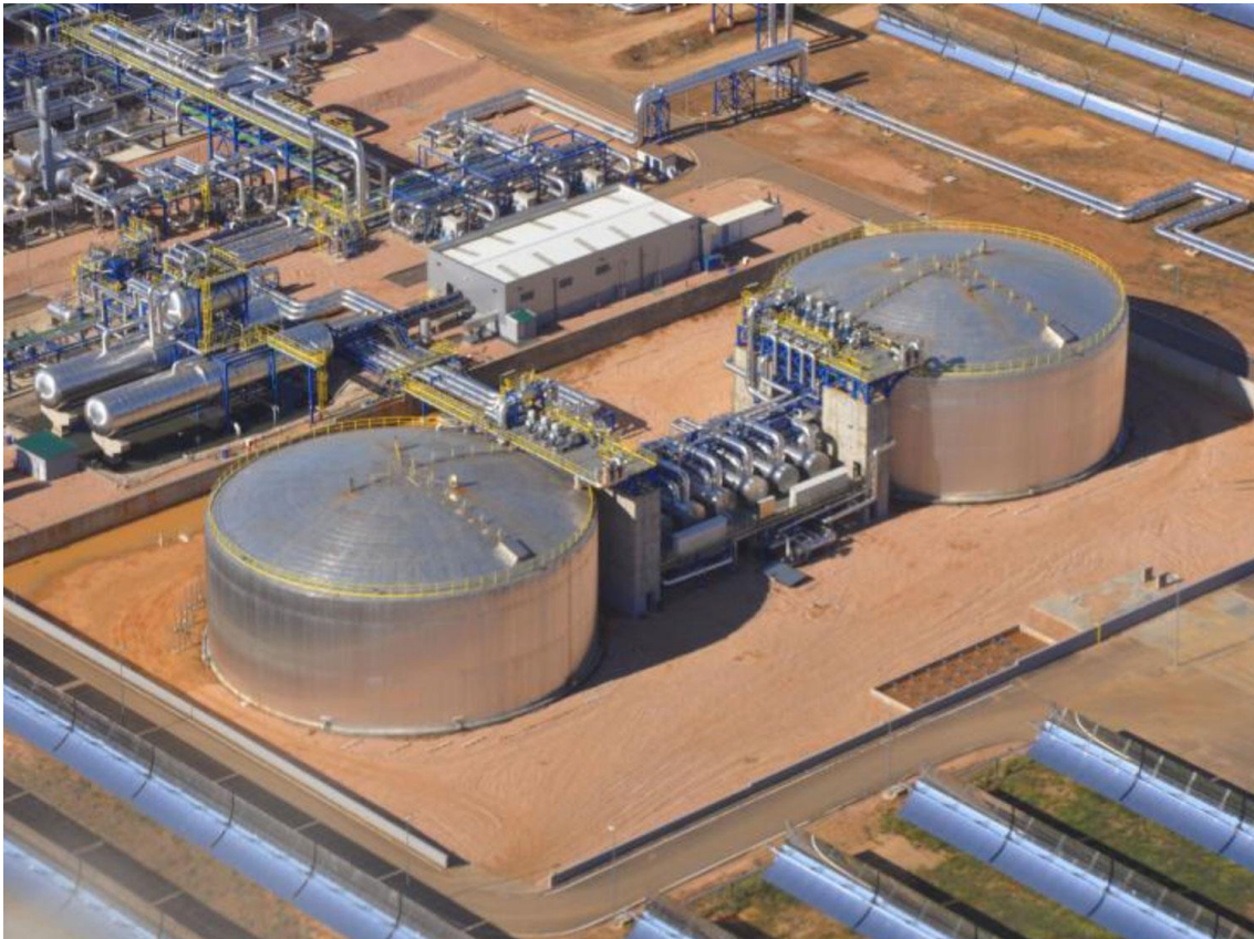
Imagen 1.10: Tanques de almacenamiento de sales fundidas
