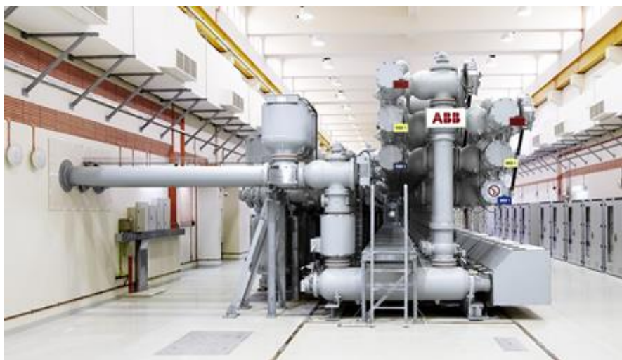
Ilustración 13. Subestación tipo GIS aislada en SF 6
