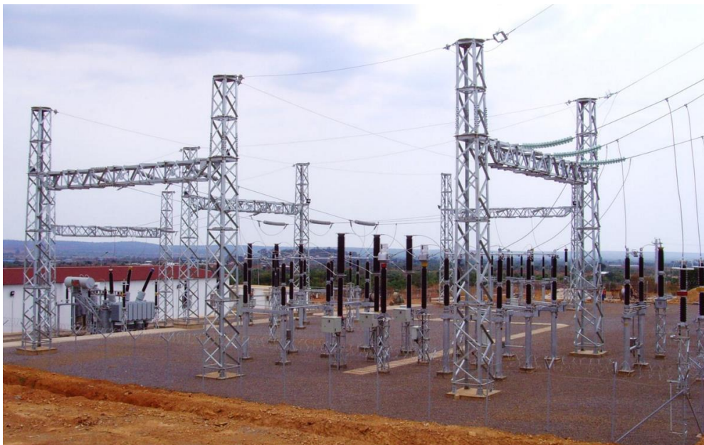
Ilustración 11. Subestación tradicional de intemperie aislada en aire, tipo AIS
