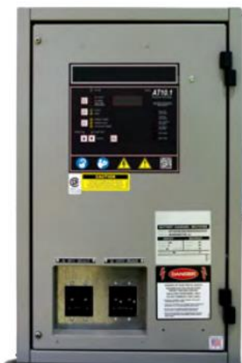
Ilustración 26. Cargador-rectificador de las baterías
