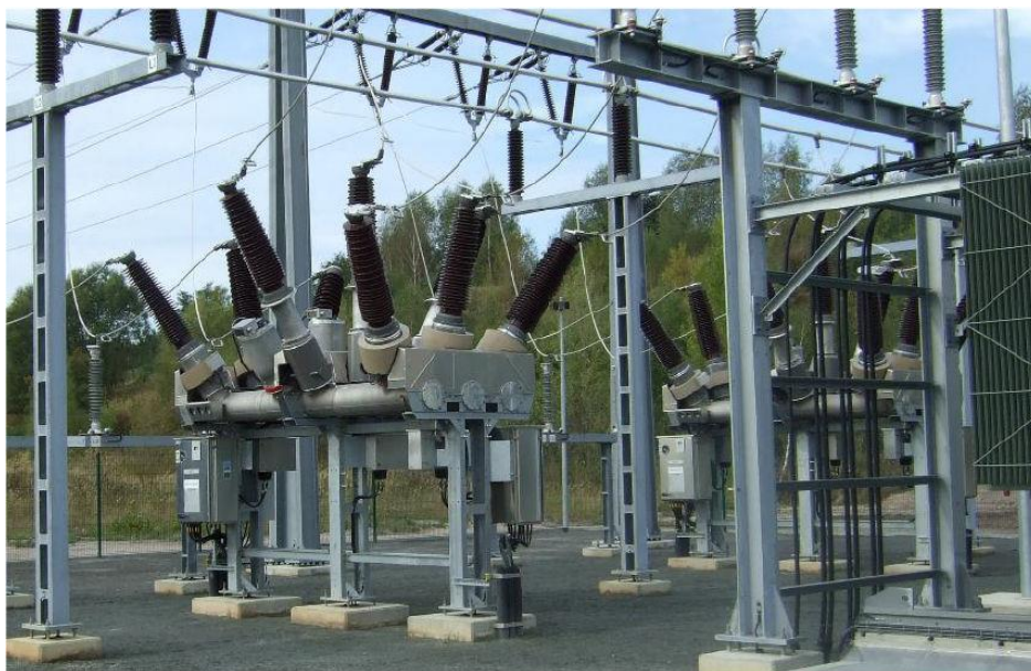
Ilustración 12. Fotografía tomada de una subestación tipo HIS
