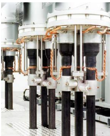
Ilustración 19. Aspecto físico del terminal de cables de la ELK-04
