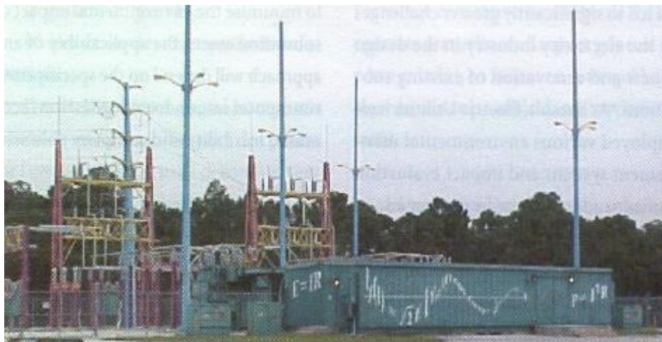
Ilustración 13. . Subestación con mejora de estética.
