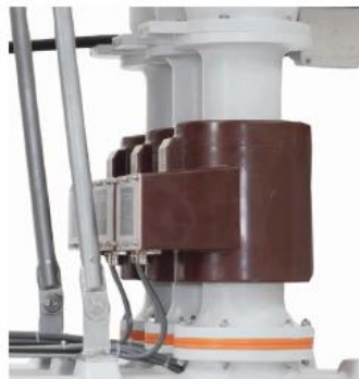
Ilustración 40. Vista exterior del transformador de intensidad.
