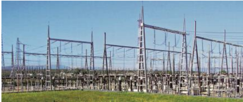
Ilustración 12. Subestación de San Sebastián de los Reyes (REE).
