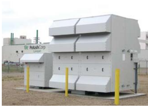
Ilustración 26. Vista de la envolvente metálica del transformador.
