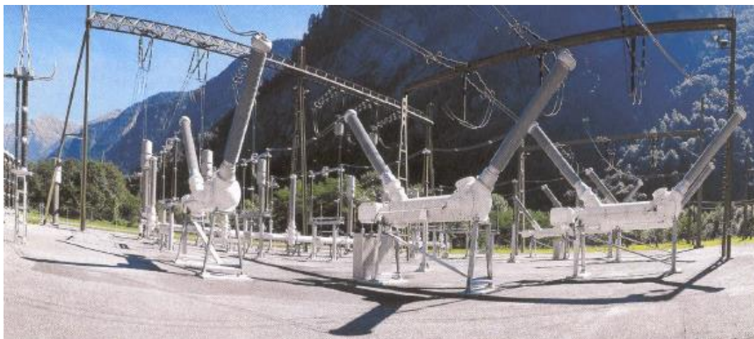
Ilustración 15. Vista de una subestación HIS.
