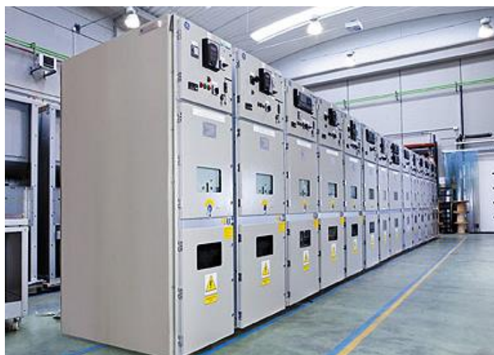
Ilustración 16. . Celdas de media tensión.
