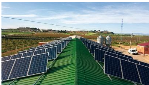
Figura 4. Sistema solar fotovoltaico junto con grupos electrógenos.
