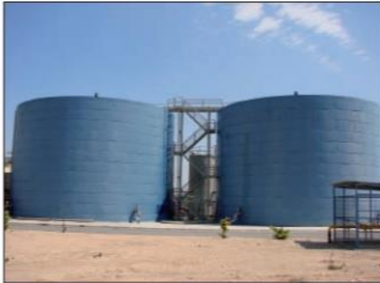
Figura 28: Digestores anaerobios de mezcla completa. Fuente [IDAE07].
