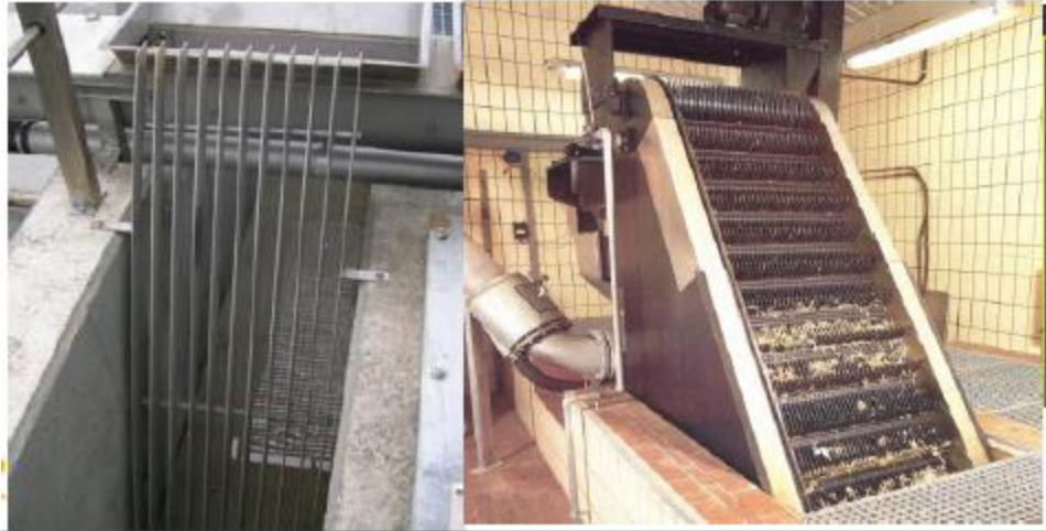
Figura 10. Ejemplos de instalaciones de desbaste (izq) y tamizado (drcha.). Fuente: [CLED17]
