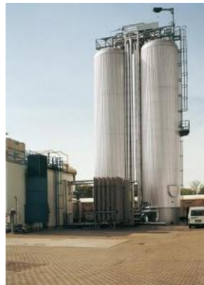
Figura 48. Depósito de hidrógeno criogénico [Isover]
