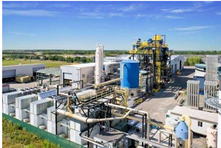
Figura 30. Planta de gasificación por plasma en desuso en Ottawa
