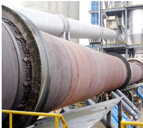
Figura 18. Horno rotativo utilizado en una incineradora de Shanghái
