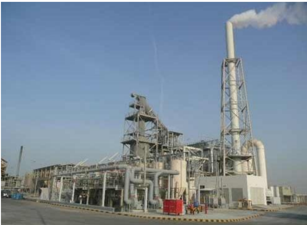
Figura 28. Planta de gasificación por plasma en Pune (India)
