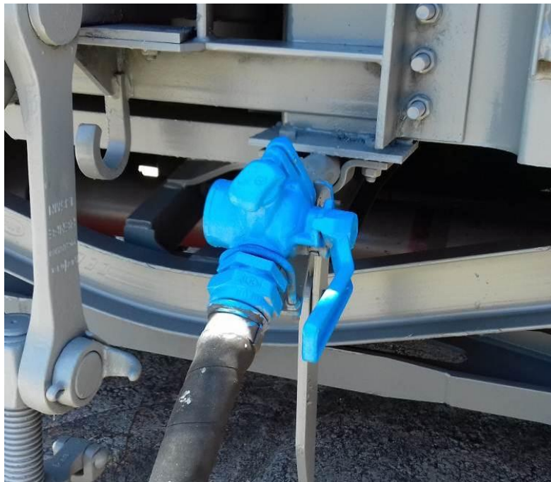
Figura 5.14. Grifo de aislamiento y manga TFA de un extremo del vagón.
