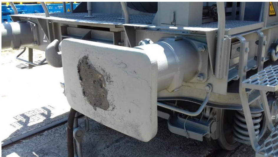
Figura 5.10. Conjunto de choque del vagón. Tornillos de fijación con par de apriete de 600 N.m.
