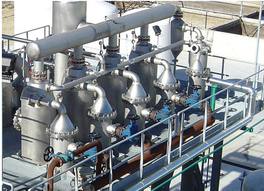
Fig 25. Planta de producción de biogás con evaporización de digestato. Fuente: TECPA.
