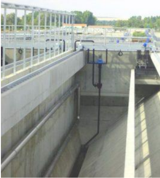
Fig 23. Tratamiento físico en una EDAR. Fuente: TECPA.
