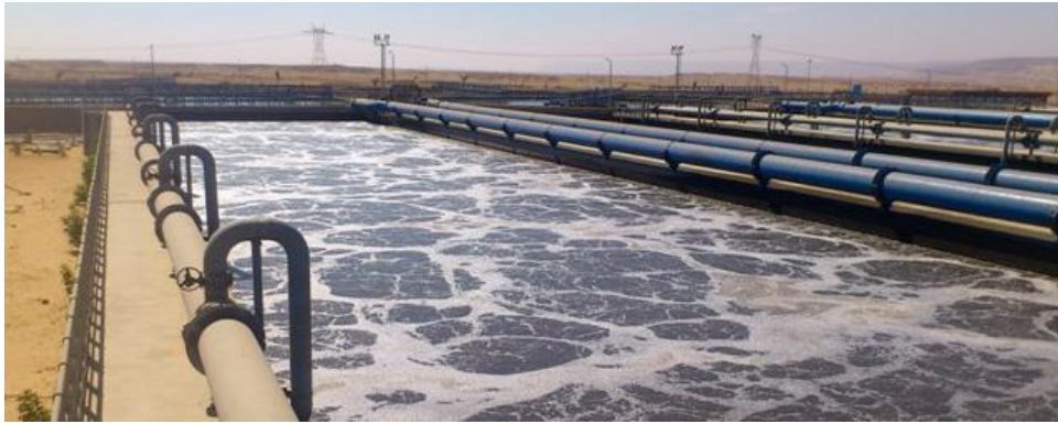
Fig 14. Reactor biológico de Costa Brava. Fuente: Consordi Costa Brava.
