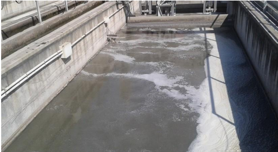
Fig 35. Fotografía del pretratamiento de una EDAR procedente de iAguá.
