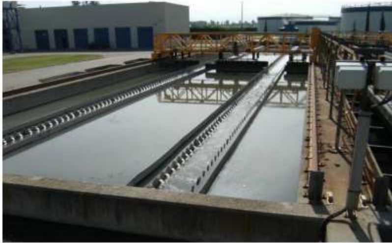
Figura 16: Decantador Rectangular: Fuente CEDEX 2014.
