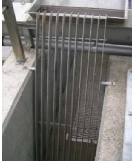
Figura 8: Rejas de Gruesos en Posición Inclinada.
