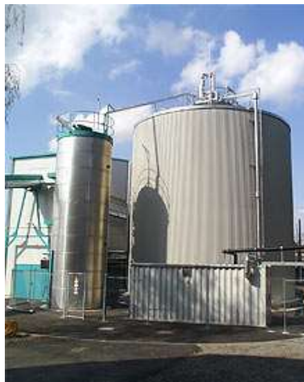
Figura 19: Imagen de Reactor de Digestión Anaerobia.
