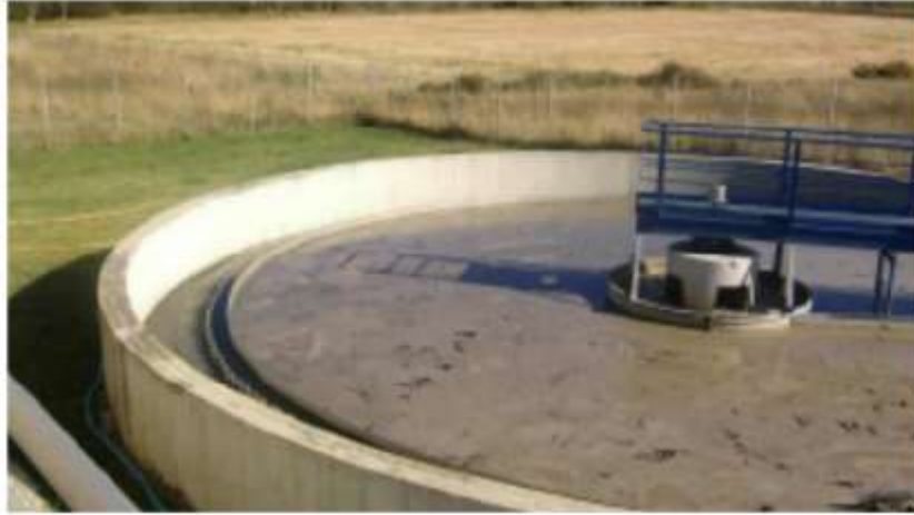
Figura 21: Tanque de espesamiento por Gravedad.
