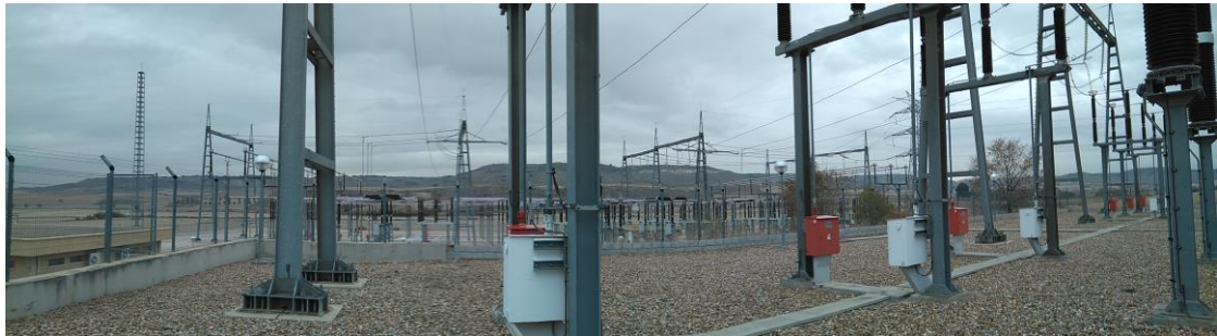
Ilustración 30 Instalación al fondo que abastece la SET del Anchuelo (una de la LAV Madrid-Barcelona) propiedad de REE
