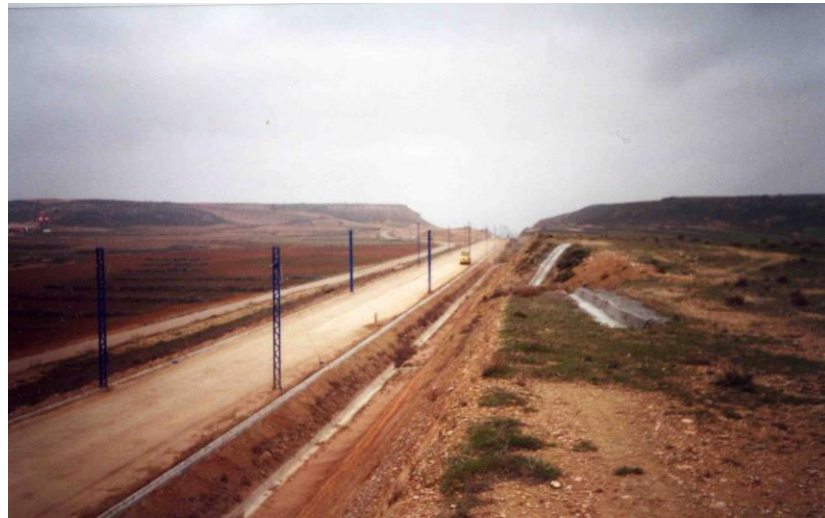
Ilustración 19 Plataforma, pequeño desmonte y superficie horizontal de la LAV Madrid-Barcelona a unos 20 km del río Cinca
