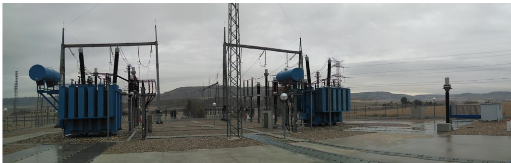
Ilustración 31 Parte de la SET del Anchuelo propiedad de ADIF
