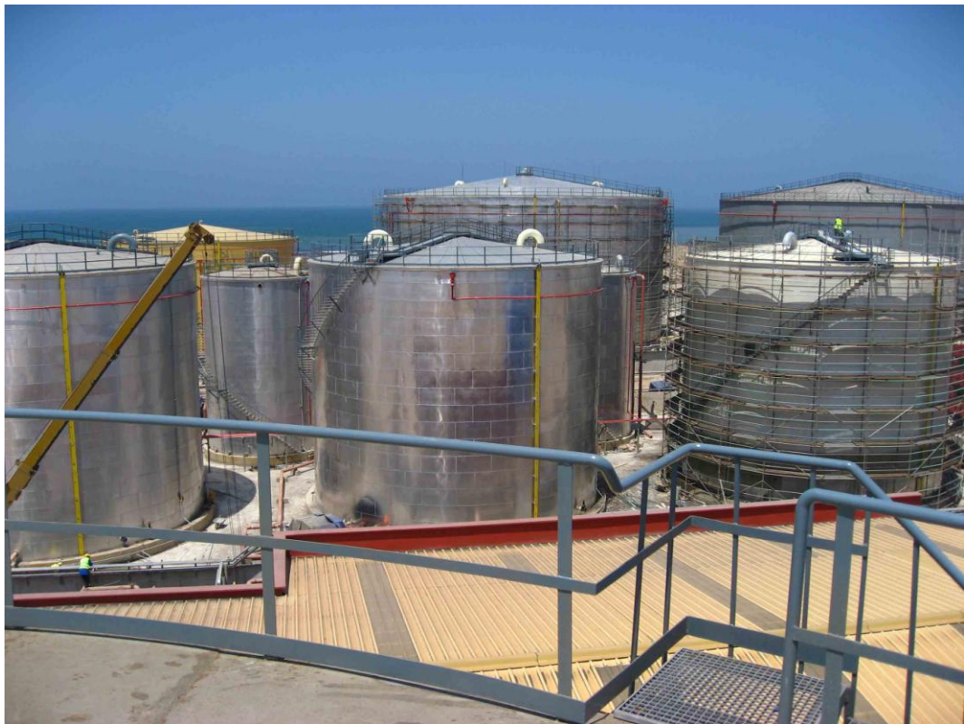
Figura 2-15- Tanques de almacenamiento
