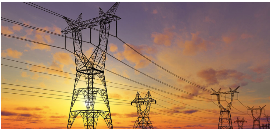
Figura 5. Ilustración de líneas de alta tensión de la Red Eléctrica de España. Fuente: [24]
