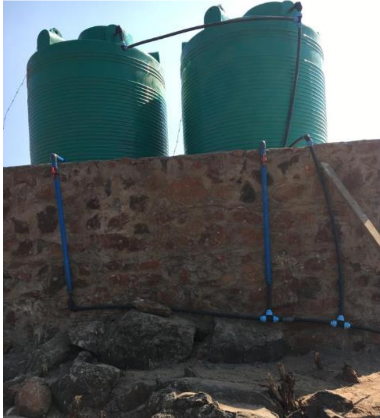
Ilustración 59: Ejemplo de instalación de tanques
