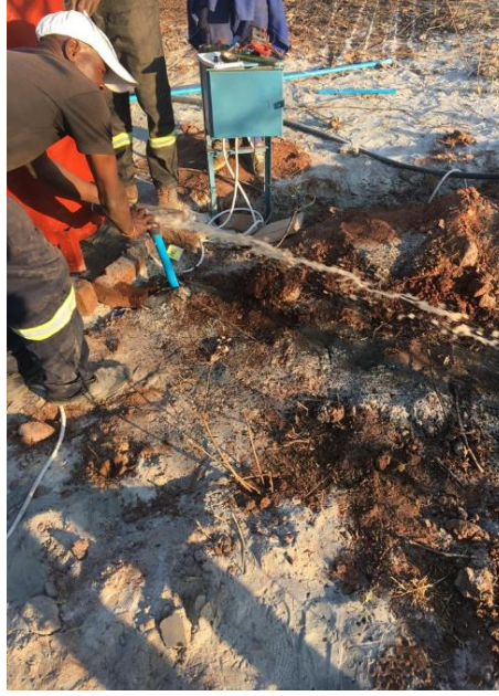
Ilustración 52: Agua saliendo de tubería
