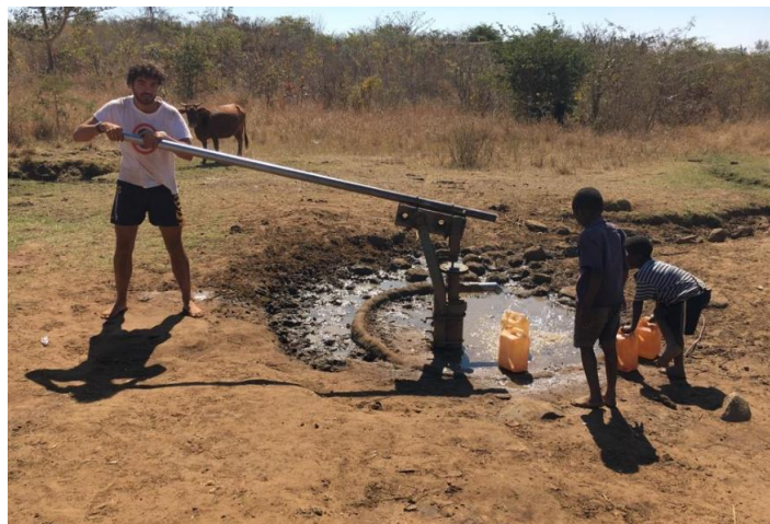
Ilustración 38: Bomba manual existente
