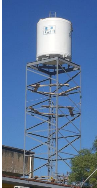
Ilustración 42: Tanque sobre estructura metálica
