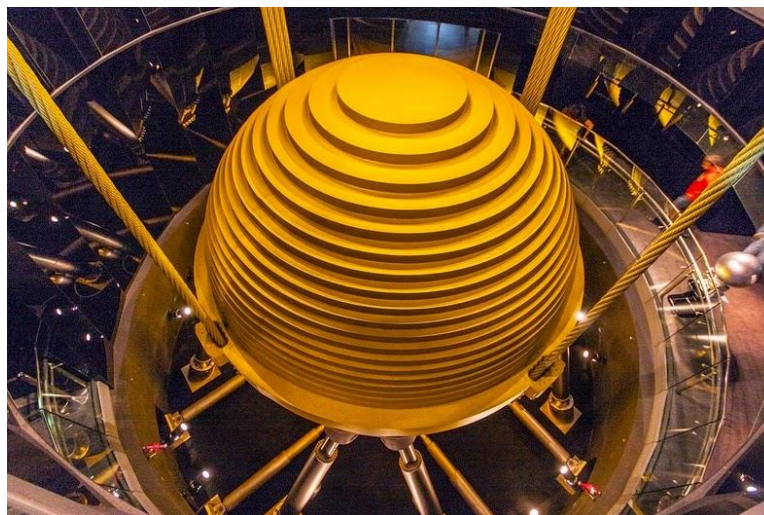
1.3 - Amortiguador de masas situado entre el piso 87 y 91 del Taipei 101.
