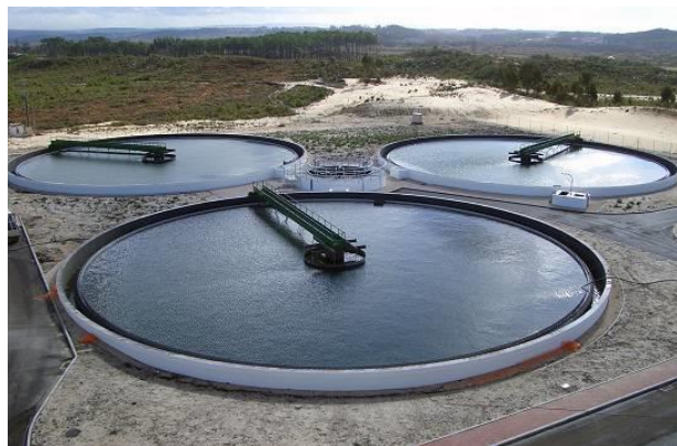
Ilustración 4. Decantador primario. Fuente: [DAGA19]
