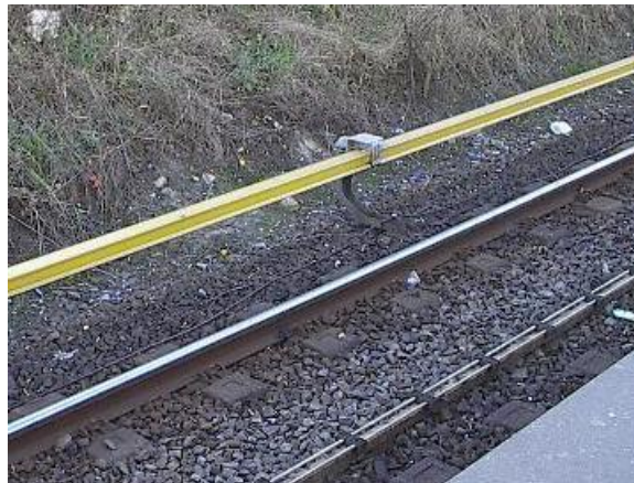
Figura 1: Sistema de tercer carril instalado en vía ferroviaria
