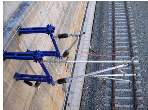
Figura 11: Aisladores en una ménsula
