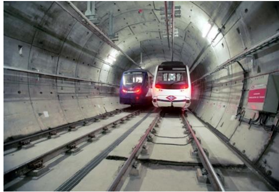
Figura 2: Catenaria rígida en el metro de Madrid
