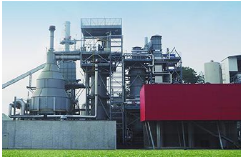
Figura 17. Proyecto de planta de Morcenx, Francia (Central Eléctrica Cho Morcenx, n.d.)
