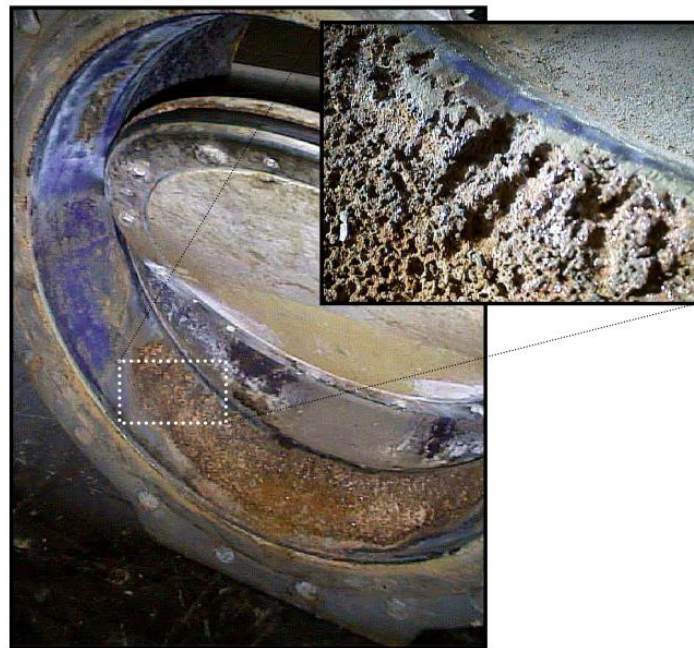
Ilustración 41: Daños provocados por cavitación. Fuente [20]
