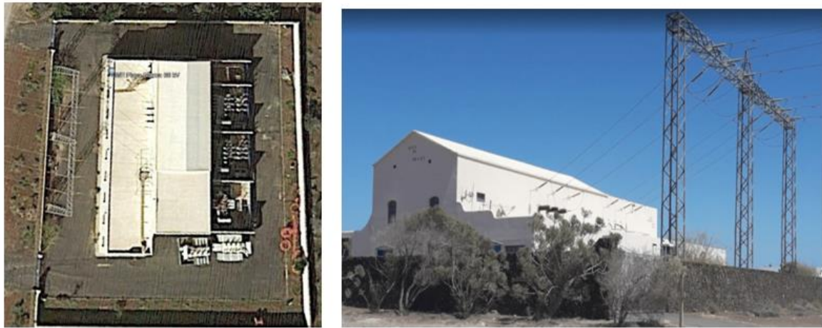
Figura 21: Subestación Eléctrica Playa Blanca 66/132 KV [7]
