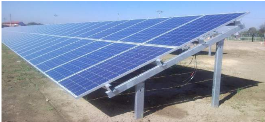
Ilustración 10: Estructura fija sobre suelo hincado. Fuente: Industrias Duero, 2016.
