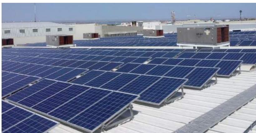
Ilustración 11: Estructura fija inclinada sobre cubierta. Fuente: Suports.
