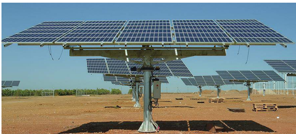
Ilustración 14: Estructura móvil sobre dos ejes. Fuente: Magtel.
