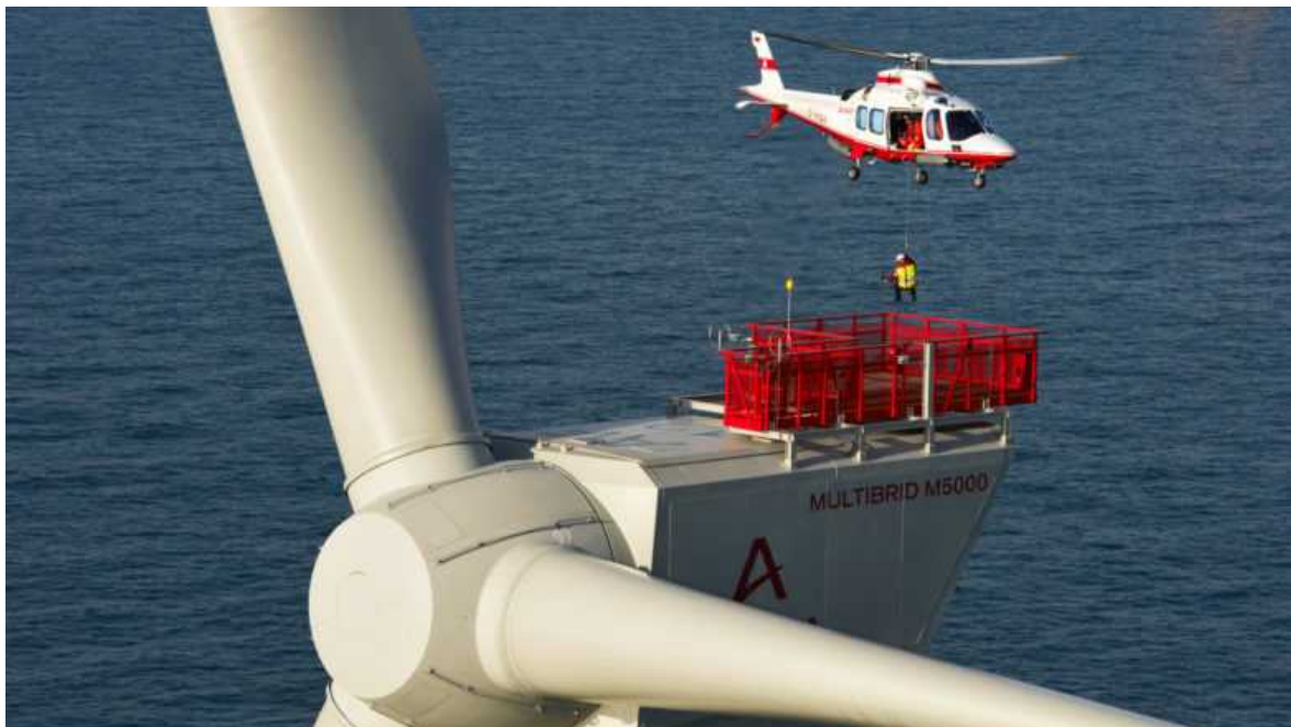
Figura 47. Mantenimiento de una turbina eólica marina [47]
