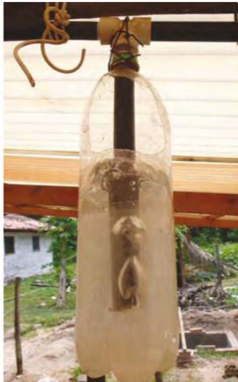
Figura 26: Resultado de la válvula de seguridad del biodigestor de un proyecto en Bolivia (Fuente: Guía de biodigestores)
