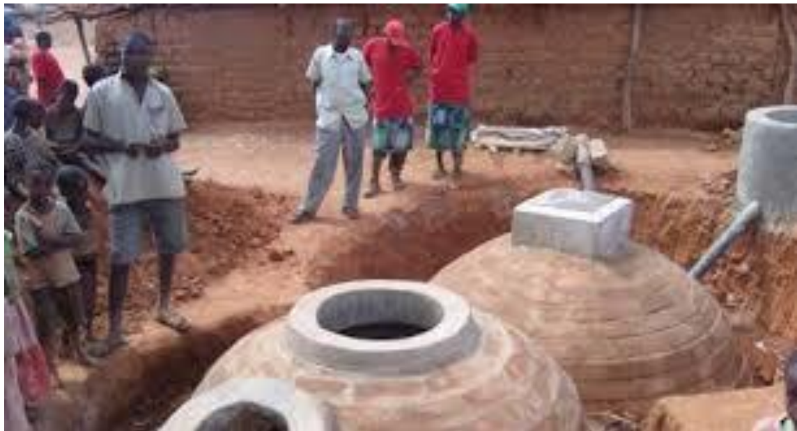
Figura 13: Construcción del biodigestor de ladrillo en un país subdesarrollado (Fuente: Investigación y experiencias de multiplicación en países tropicales- Proporcionado MMUU [3])
