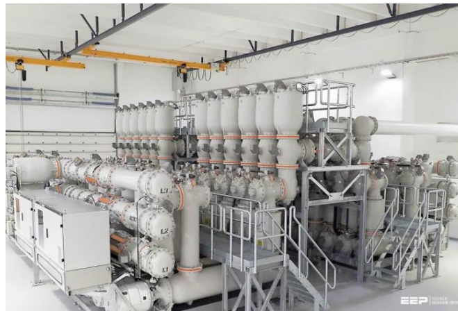
Figura 5 Subestación GIS (Fuente: EEP)
