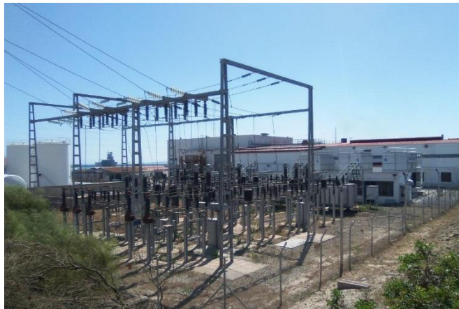
Figura 6 Subestación AIS (Fuente: Grupo Cobra)
