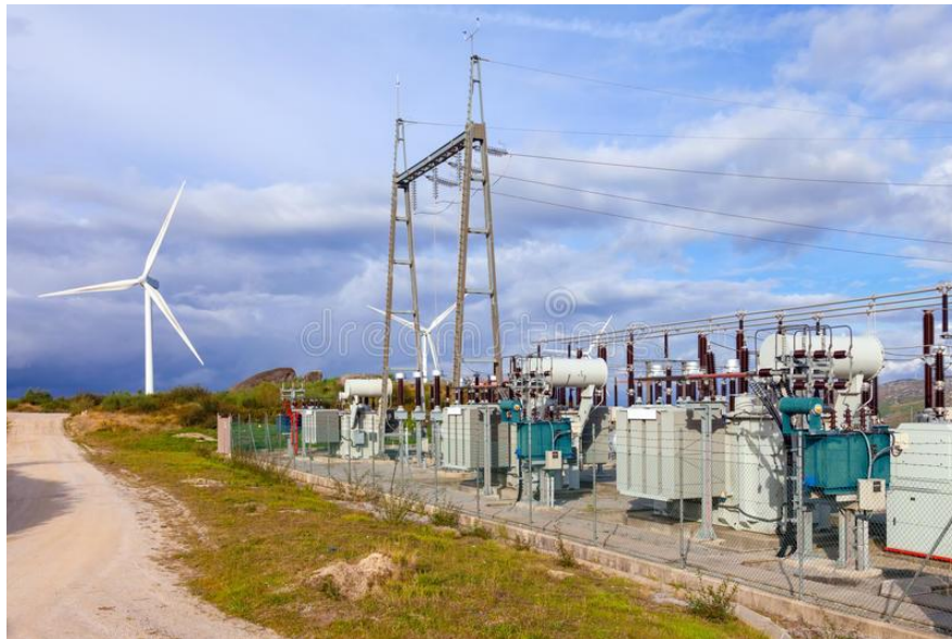
Figura 16: Subestación elevadora en un parque eólico (dreamstime.com)
