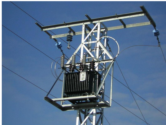
Figura 4. 4 Centro de transformación en poste [4.4]
