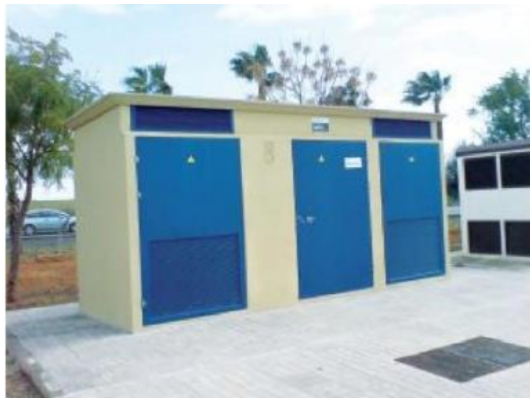
Figura 4. 5: Centro de transformación en caseta [4.5]
