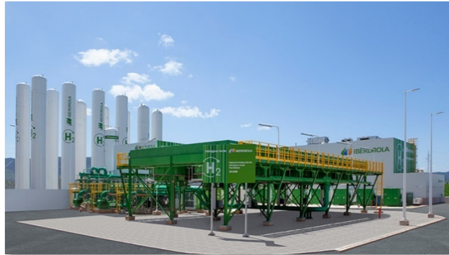
Figura 21: Planta de Hidrógeno Verde en Puertollano (Ciudad Real), España [29]
