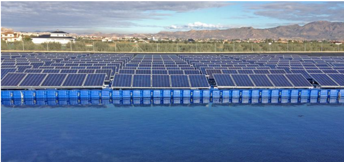
Ilustración 6. Instalación fotovoltaica flotante en Lorca, Murcia. Esfera Solar.
