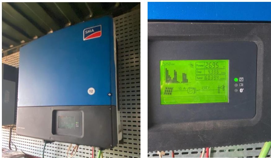
Figura 48: Inversores fotovoltaicos. Fuente: Elaboración propia
