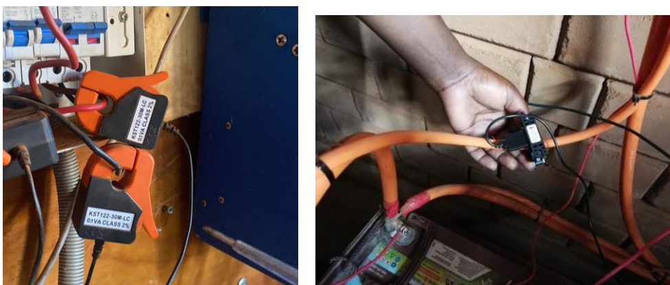
Figura 24: sensores que miden la energía consumida y producida
