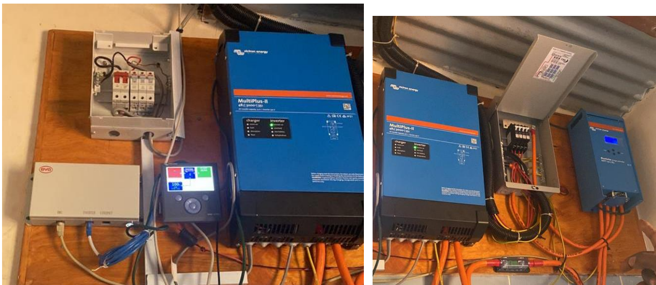
Figura 42: Instalación eléctrica del Clinic.
