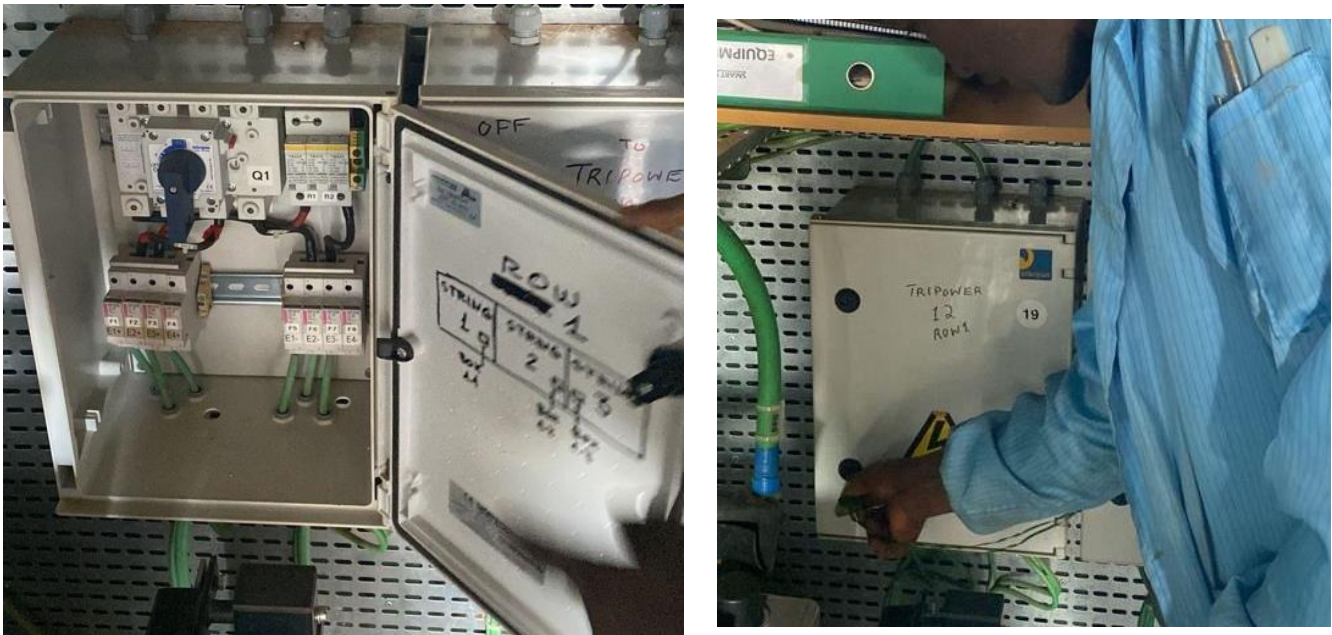
Figura 51: Cajas combinadoras de cada fila de placas solares. Fuente: Elaboración propia
