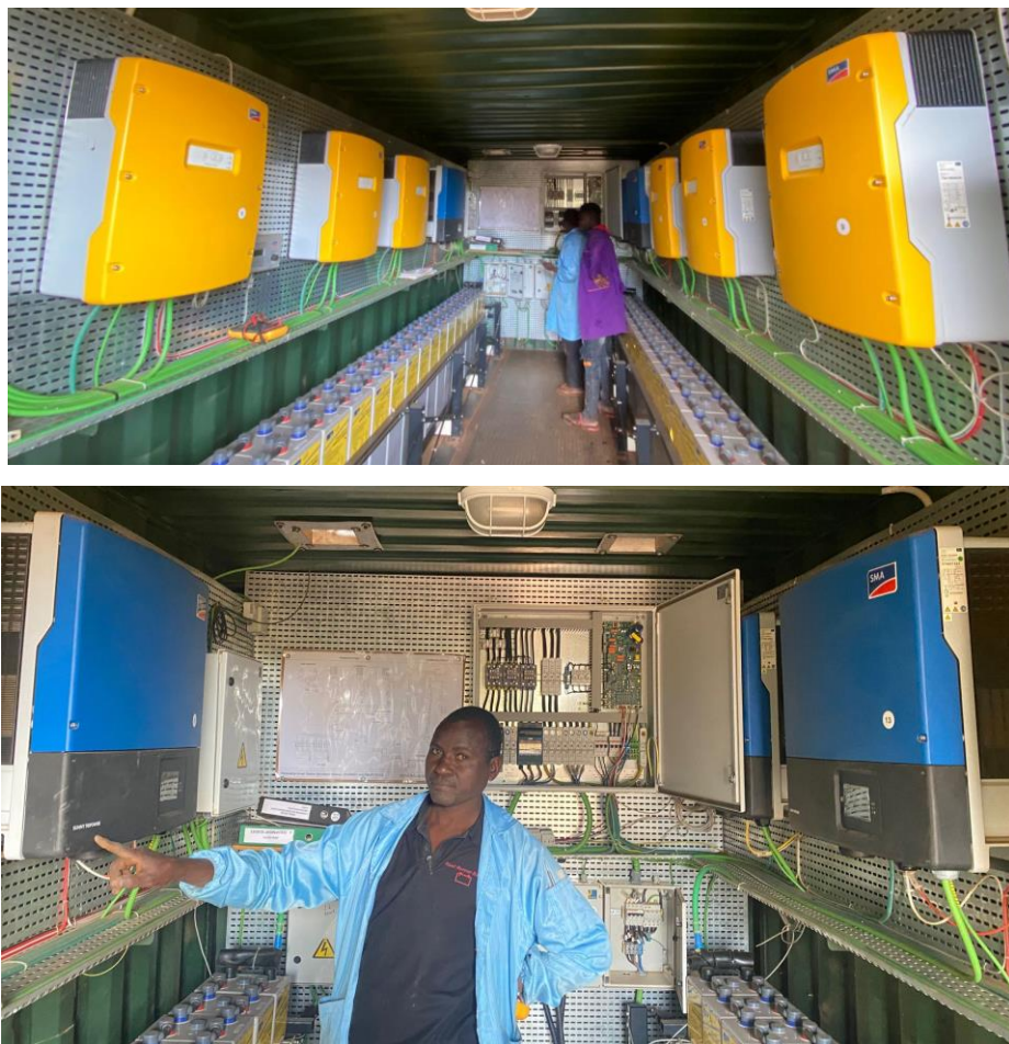
Figura 21: Dispositivos instalados. Fuente: Elaboración propia
