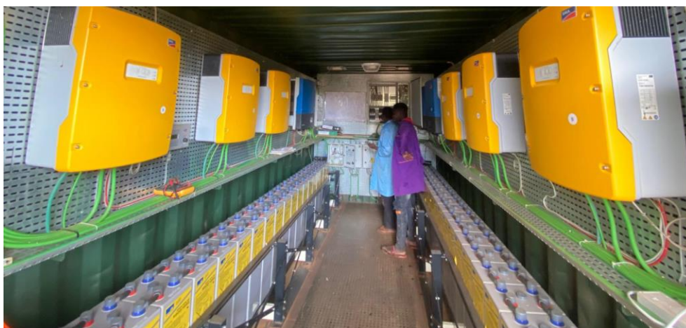
Figura 49: Dispositivos instalados. Fuente: Elaboración propia
