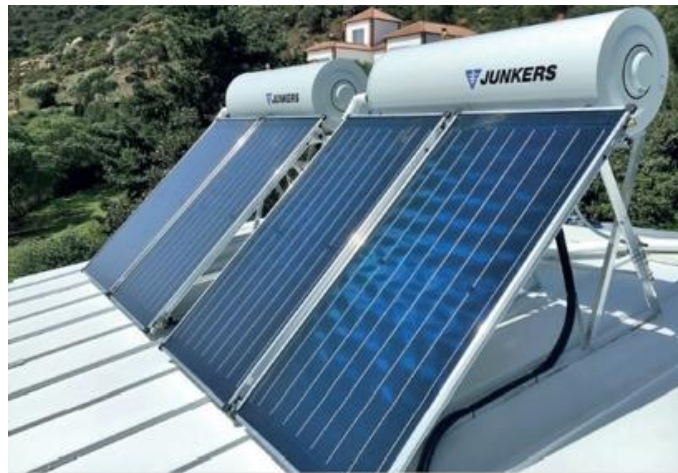
Figura 11: Paneles de energía solar térmica
