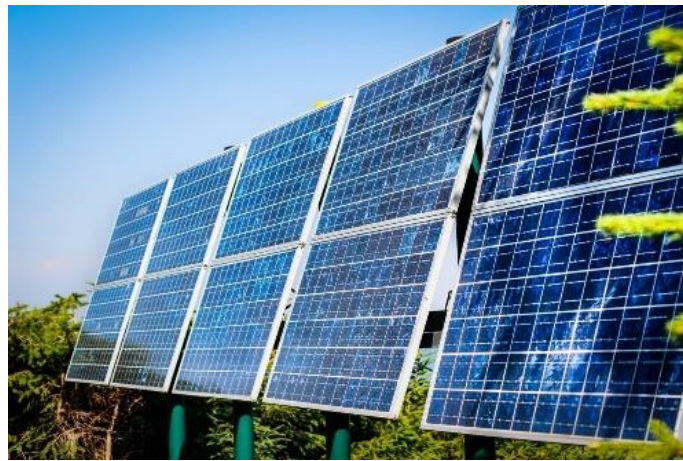
Figura 10: Paneles de energía solar fotovoltaica
