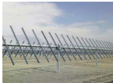
DETALLE DE SEGUIDOR SOLAR SOLTEC
