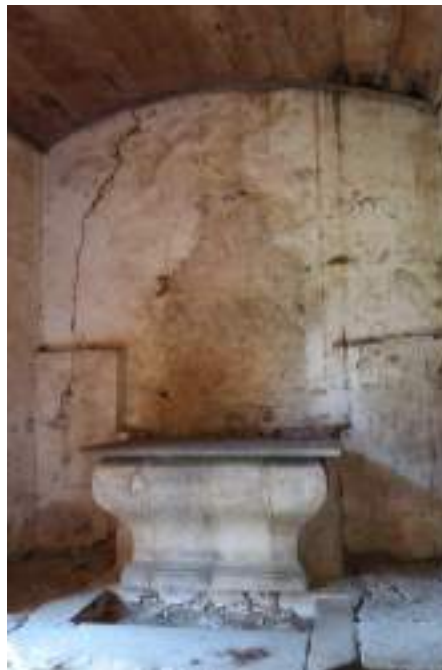
Figura 1.1: Grietas en las paredes de la capilla. Fuente: Gestinsa Inmobiliaria, 2023
