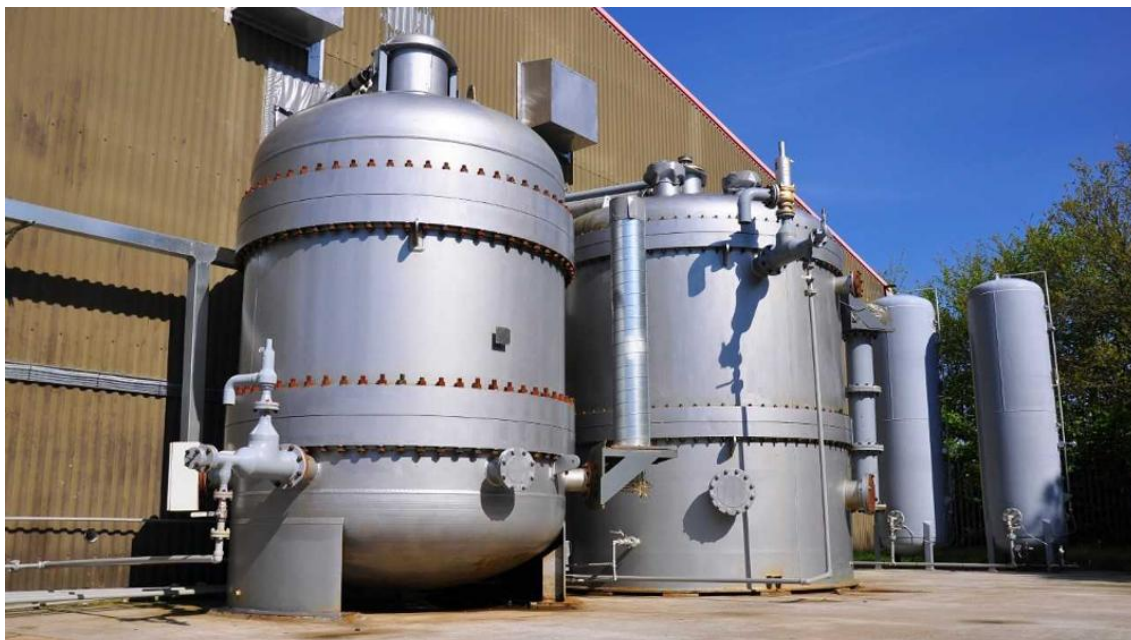
Figura 2.14: Tanques de almacenamiento del proyecto de baterías de Carnot de la Universidad de Newcastle. (Fuente:[24])
