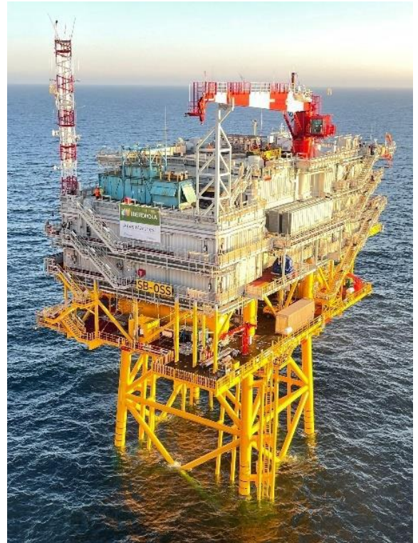
Ilustración 11. Subestación eléctrica del parque
