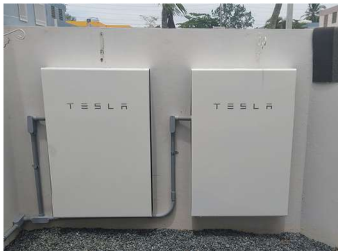
Figura 11: Baterías de Almacenamiento en una Vivienda
