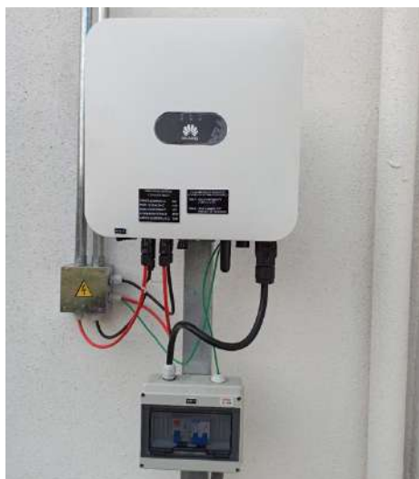
Figura 10: Inversor para paneles solares
