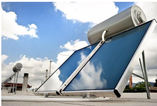
Figura 35: Cubierta con colectores solares instalados
