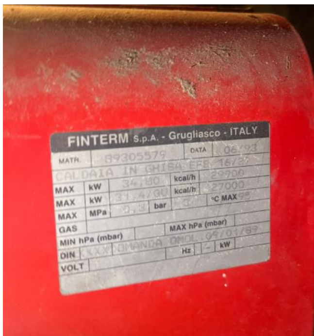
Figura 25: Placa de características de la caldera de gas. (Elaboración Propia)
