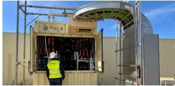
Ilustración 3: Batería de Vanadio en Son Orlandis, Mallorca
