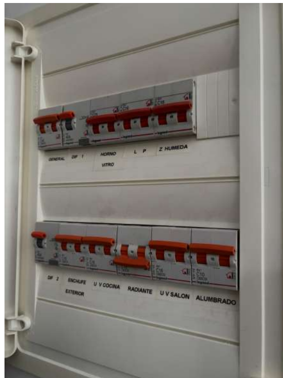
Figura 7.3: Cuadro eléctrico de la zona del porche exterior. Fuente: elaboración propia.
