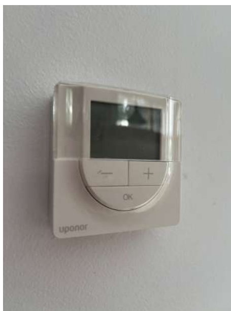
Figura 7.7: Termostato digital instalado en el porche exterior para control independiente de la climatización. Fuente: elaboración propia.
