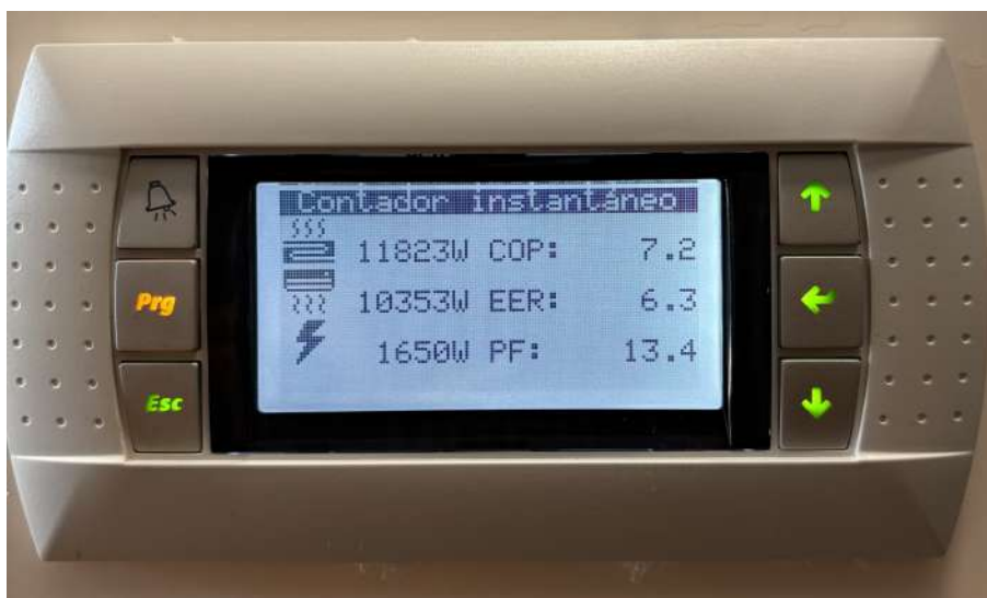
Figura 7.16: Lectura instantánea del contador: Datos de potencia térmica útil y indicadores de rendimiento instantáneos. Fuente: Elaboración propia.
