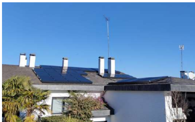
Figura 1.10: Vista exterior, instalación fotovoltaica para autoconsumo eléctrico. Fuente: elaboración propia.
