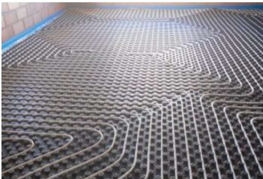
Figura 2.2: Suelo radiante. Fuente: Geotermia Vertical Instalaciones.
