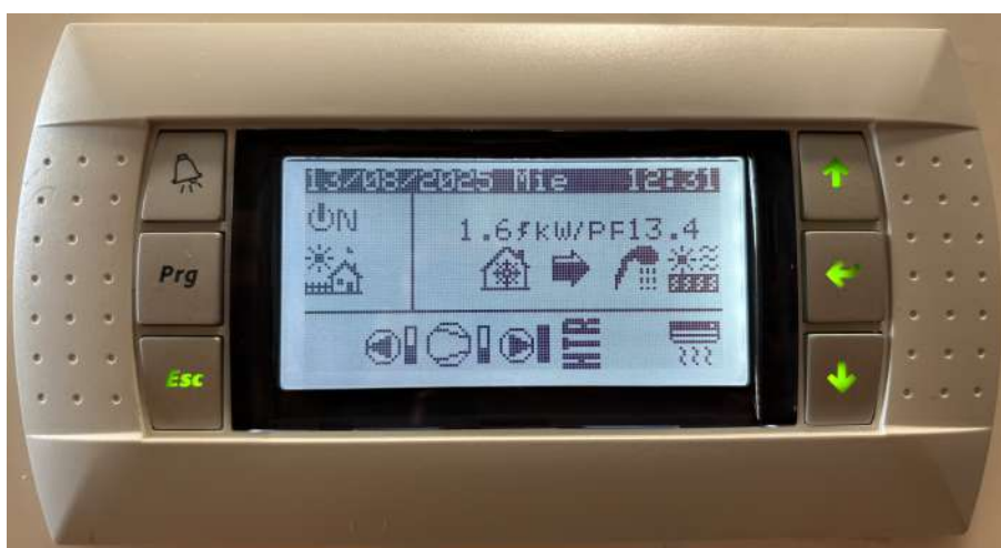
Figura 7.14: Pantalla de inicio del contador de la bomba de calor geotérmica. Fuente: Elaboración propia.
