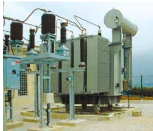
Transformadores de intensidad (CX) y tensión (UT) de 72,5 kV en protección de transformadores de potencia. Iberdrola (España).
