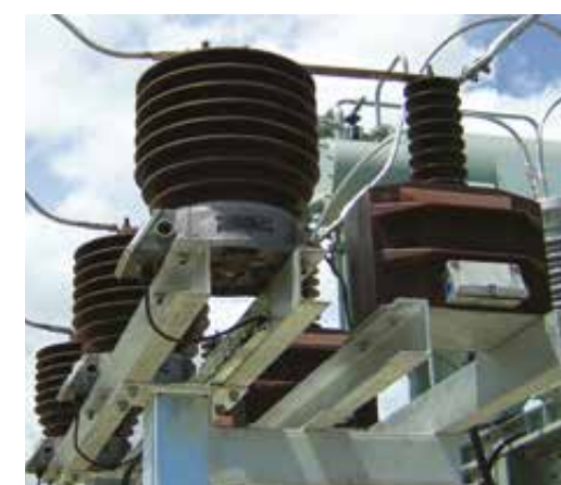
> Transformadores de intensidad (CR) y tensión (UR) de 36 kV. Medida para facturación. Electronet Services (Nueva Zelanda).
