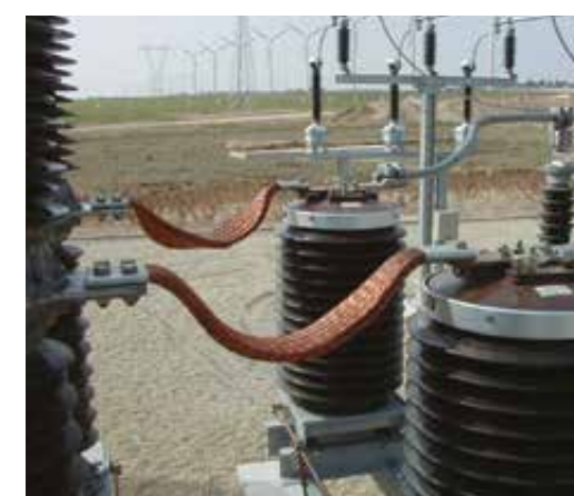
> Transformadores de intensidad (CX) de 72,5 kV dedicados a la protección de una subestación eólica. Iberdrola (España).
