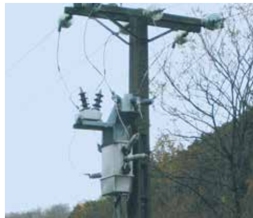
Transformadores de tensión (VJ) de 24 kV. Alimentación auxiliar de equipos de corte en automatización de la distribución.
