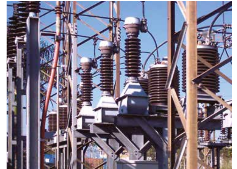
Transformadores de tensión de 36 kV (UZK). Transpower (Nueva Zelanda).
