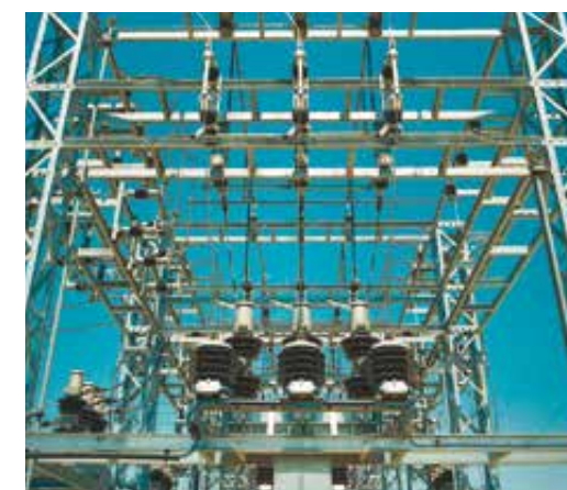
> Transformadores de intensidad (CX) 24 kV en protección de subestación. Iberdrola (España).
